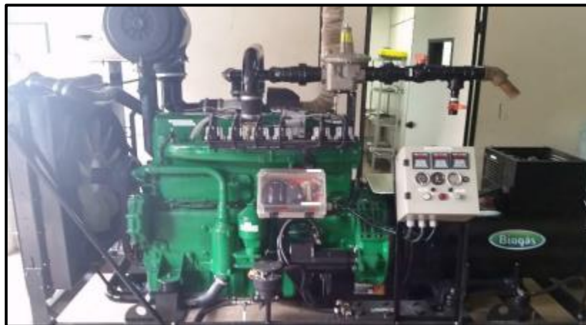
Figura 25 - Exemplo de um motor gerador a biogás que poderá ser utilizado na planta do aterro sanitário.
